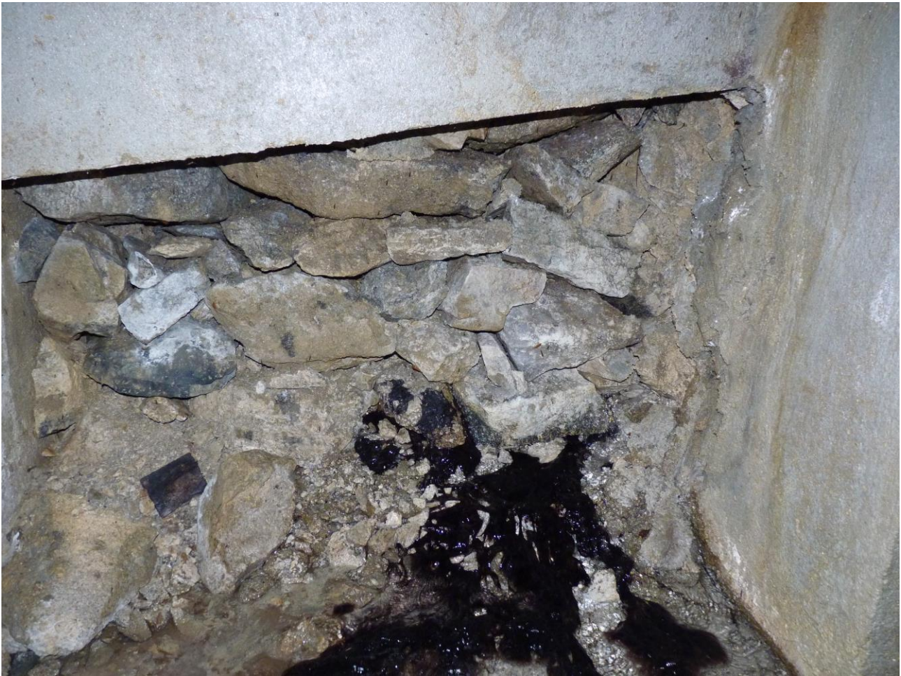
Figure 6 : Présence d'algues noires sur l'arrivée d'eau latérale à gauche
